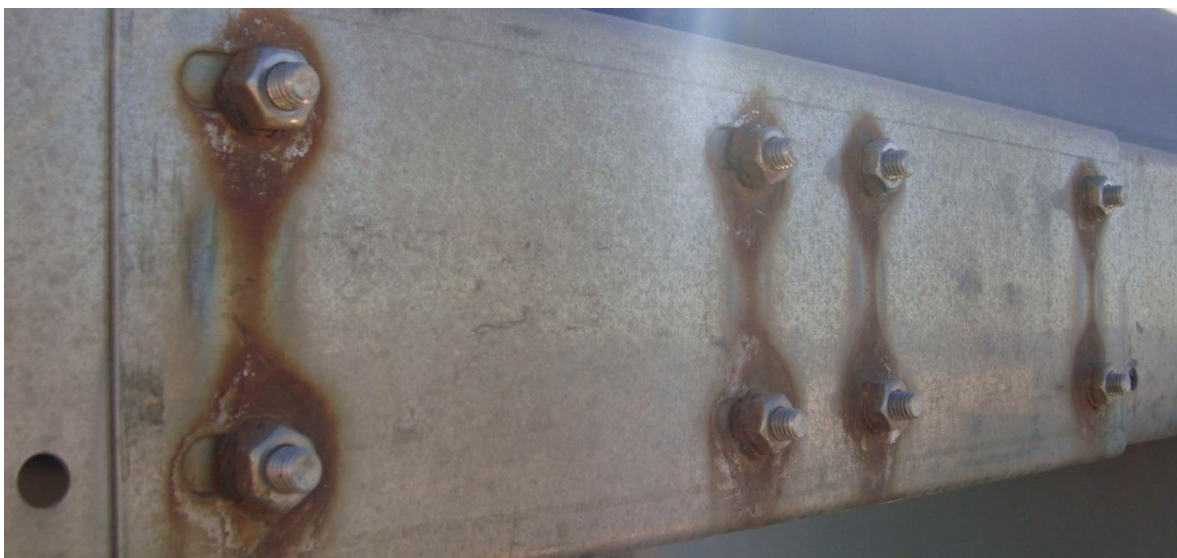
Figuur 6-11. Galvanische corrosie door contact tussen twee verschillende staalsoorten (inox bouten en stalen plaat). Source: D3j4vu at en.wikipedia
