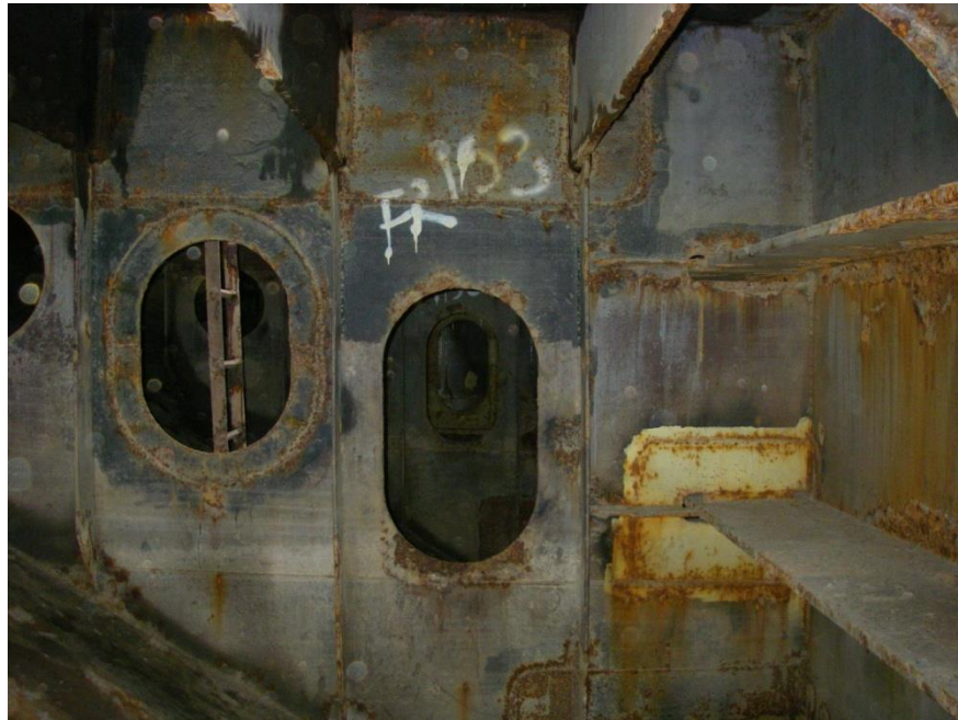
Figuur 6-7. Algemene corrosie in de ballasttanks van de Algoma Guardian, 25/09/2009
